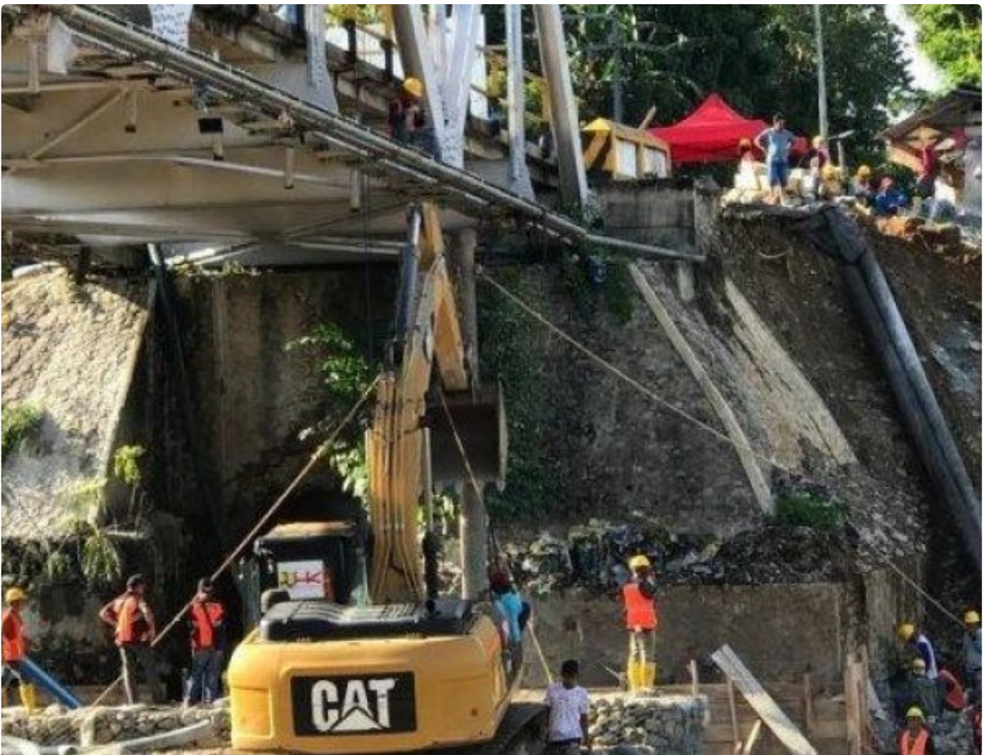
Jembatan Rampoang di Kota Palopo yang mengalami kerusakan pada tahun 2019. (Foto: IniPalopo.com)
